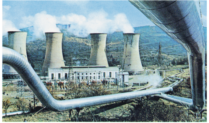
Fig. 11.20 - Tubazioni in acciaio di grande diametro (fino a 800\text{ mm} ), isolate termicamente, per convogliare all'utilizzazione il vapore estratto dal sottosuolo; sullo sfondo la più potente centrale geotermoelettrica italiana ("Larderello 3" da 120\text{ MW} ) e quattro torri di raffreddamento (ENEL).
