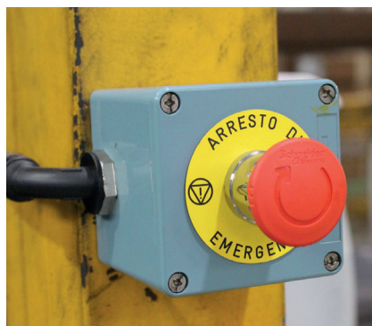
Fig. 13 - Pulsante di arresto di emergenza ("fungo rosso").
